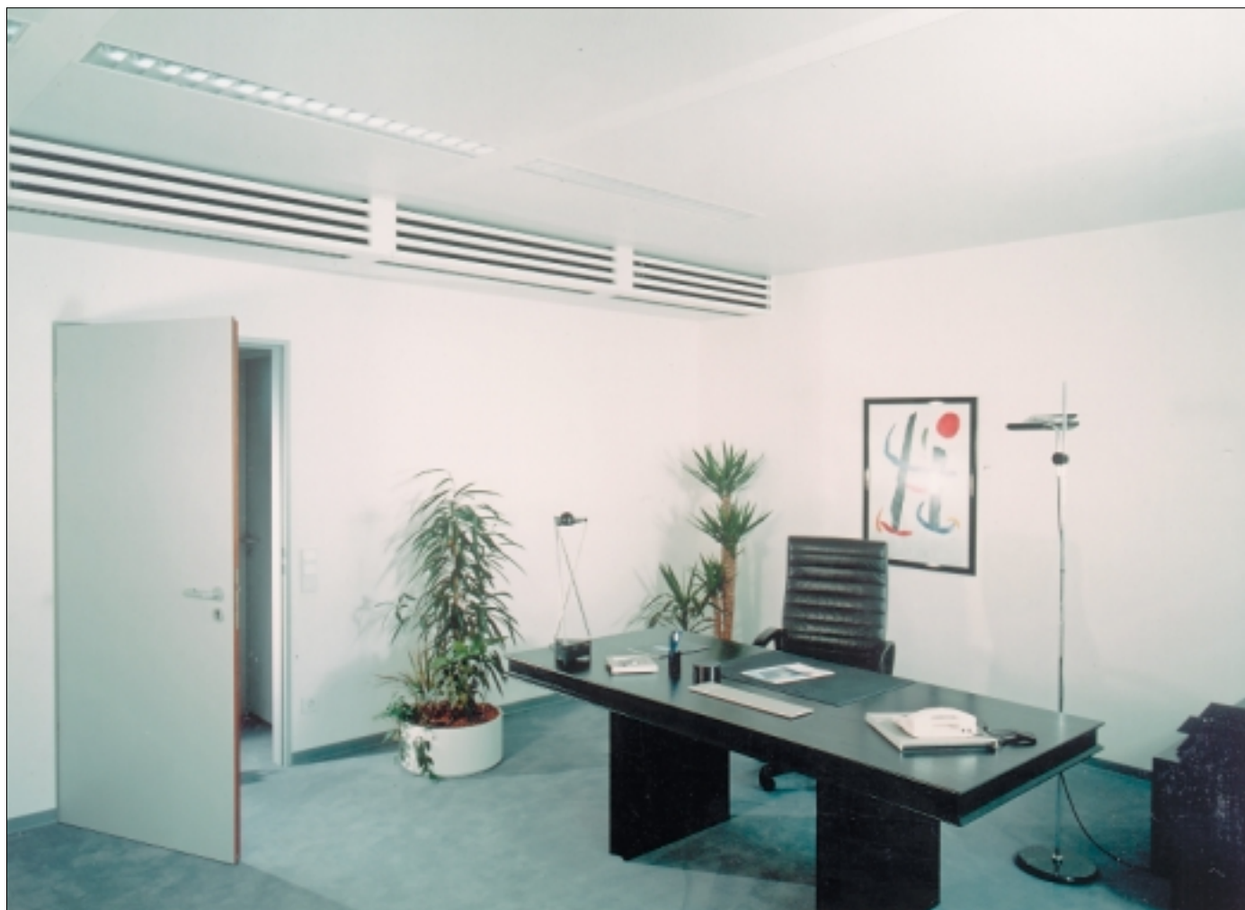
Rys. 4. Pomieszczenie biurowe z zamontowanym systemem INDIVENT
